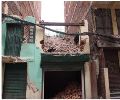
崩壊した、レンガの壁
