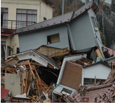
破壊され流された住宅（鮎立）
